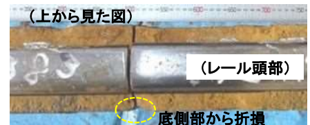
図1 底部が腐食し、折損したレールの例
